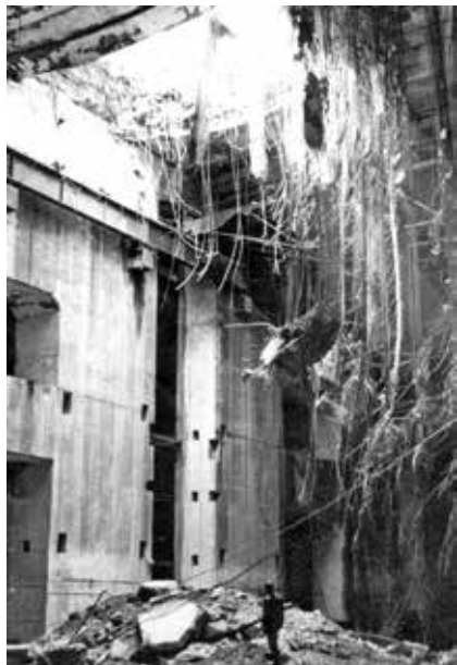
Bremen-Farge, U-Boot-Bunkers «Valentin», dégâts causés par une bombe de 10 tonnes Grand Slam
